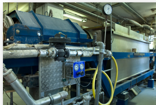
Indirekt beheizter Drehrohrofen 1 (IDO1)
